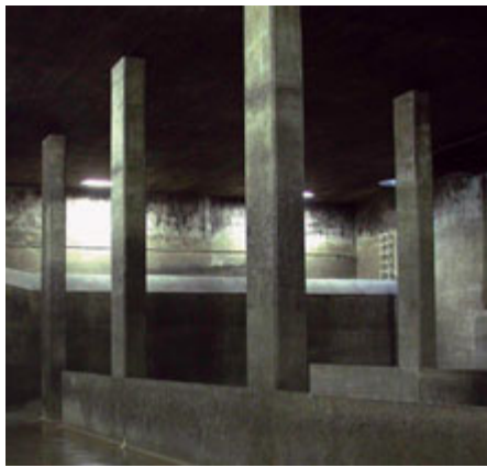
Regenüberlaufbecken Morillon – mit 3000 m 3 das grösste der Region.
