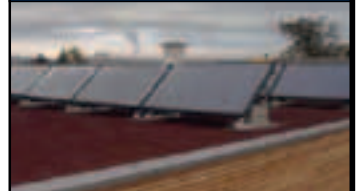
Blitzschutz und Solaranlagen
