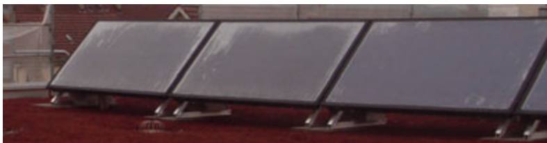
Thermische Solaranlage (Auf Flachdach)
