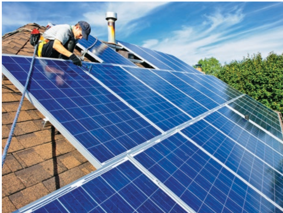
Ab 2014 gelten neue Regelungen für Betreiber von Photovoltaik-Anlagen
