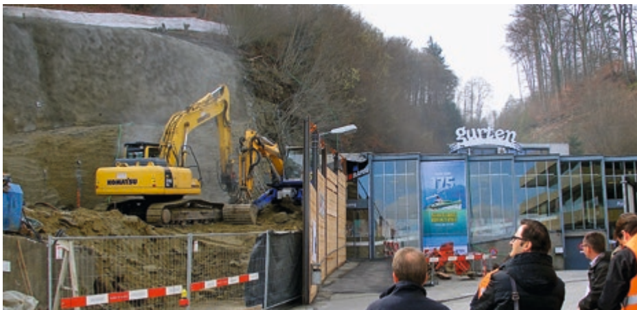
Gefahrenzone: Felsstabilisierung wäre auch ohne Vorplatz-Vergrösserung nötig geworden
