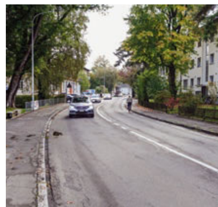
Kirchstrasse: Dringend sanierungsbedürftig
