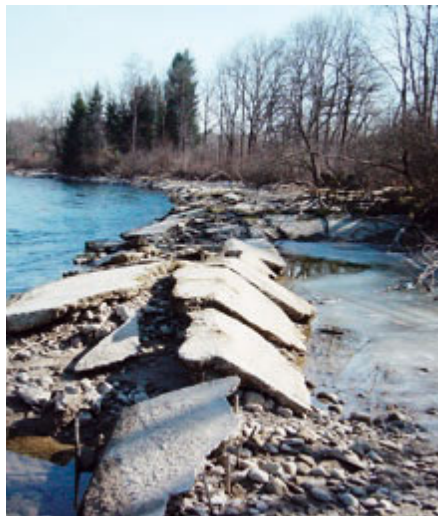
Situation vor dem Projektstart: Handlungsbedarf unbestritten Bild zvg Tiefbauamt des Kantons Bern
