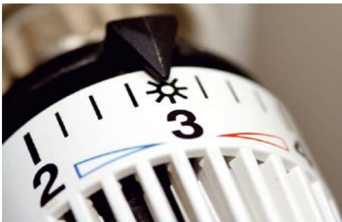
Mit dem Heizungsregler die richtige Raumtemperatur einstellen.
