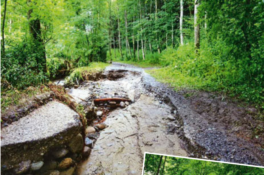
Bilder vom Unwetter im Juli 2014 – Schadensverlauf Grabenmühle. (ZVG)
