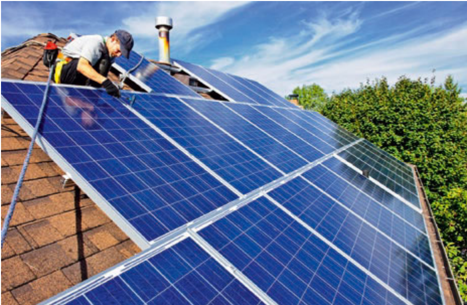
Ein Solardach in der Region Bern
