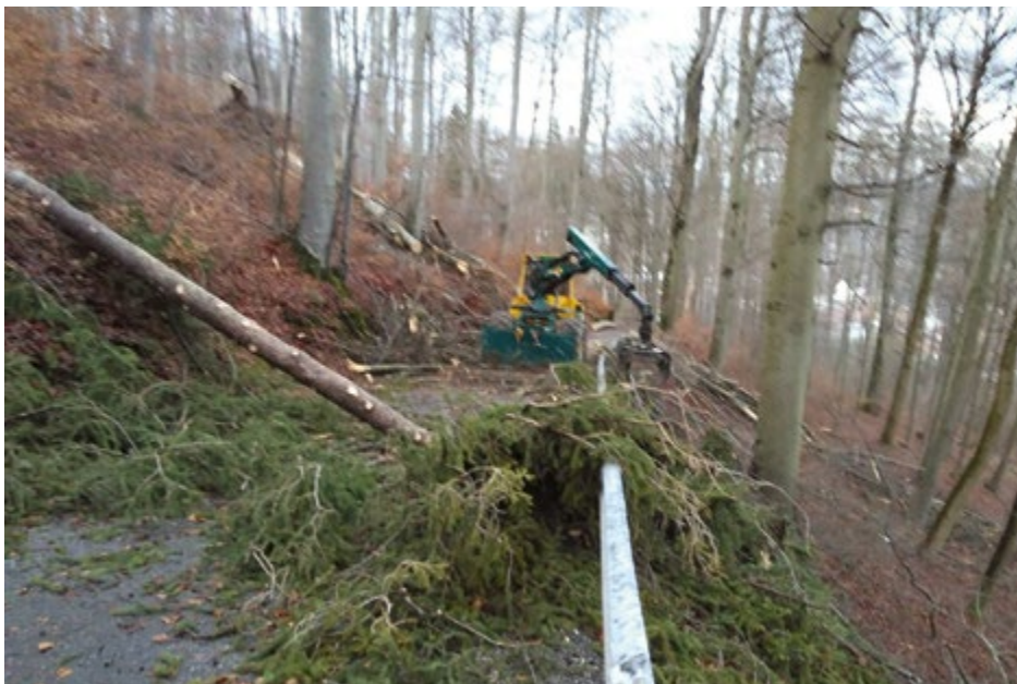
Dieses Jahr verzeichnet die Feuerwehr Köniz keine grossen oder flächendeckenden Ereignisse. Die Schadensbehebung nach dem Sturm Burglind im Januar gab jedoch einiges zu tun.
